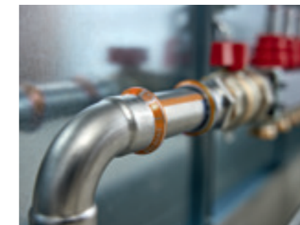
Liittimissä on pysyvä merkintä "ei juomavedelle"
