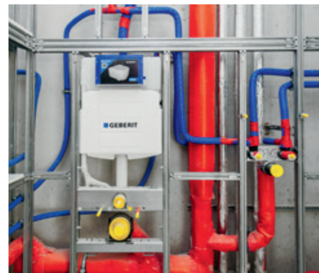
↑ GIS, joka esiteltiin vuonna 1993, on Geberitin vastaus saniteettitilojen esivalmistettujen seinien tekemiseen kipsilevyrakentamisessa. Se soveltuu erityisesti valmiiden saniteettiseiniä esivalmistukseen, mikä nopeuttaa asennusta työmaalla.
